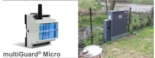
Overvågning af niveau i pumpebrønde
