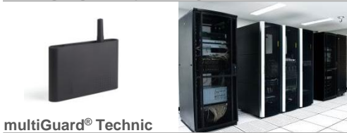
Overvågning af temperatur og strøm i serverrum
